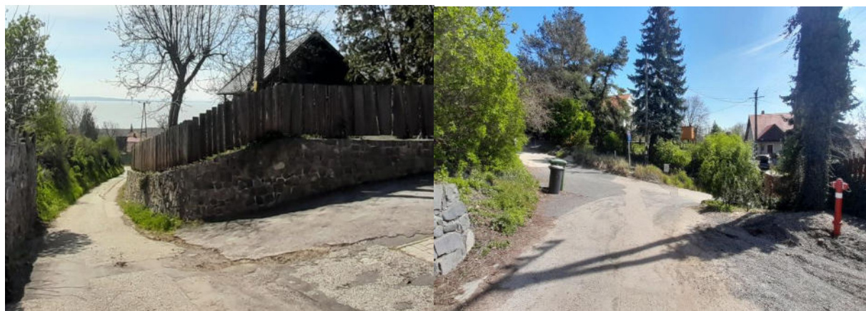
066/2 hrsz. töredezett aszfaltszél (109. ábra)
