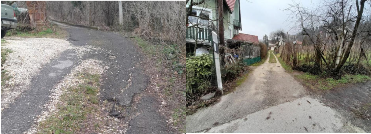
A felső útszakasz nagyon kátyús (87. ábra)
