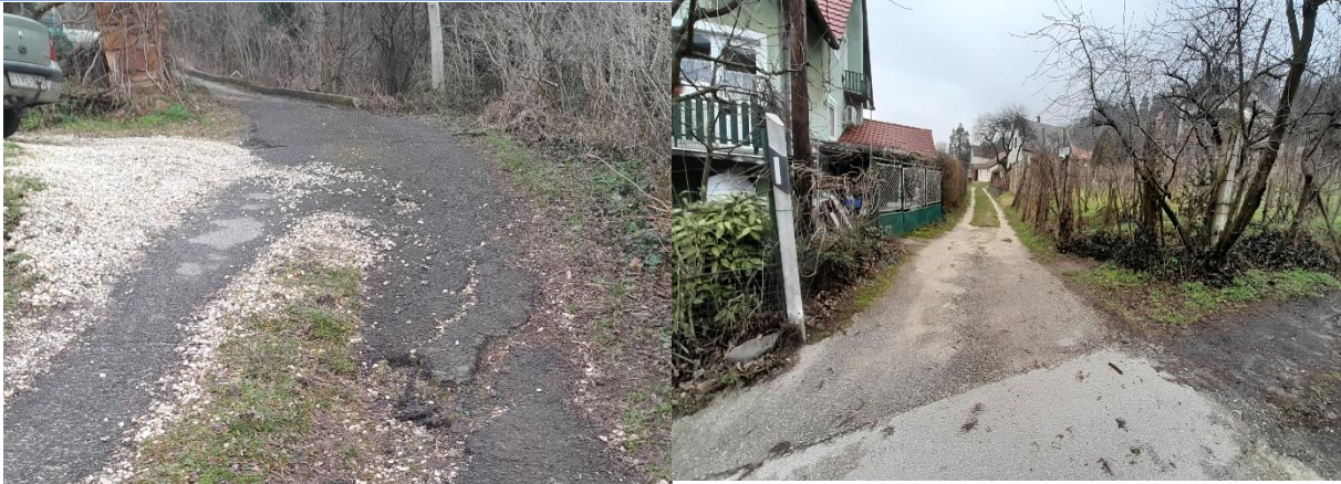
A felső útszakasz nagyon kátyús (87. ábra)
