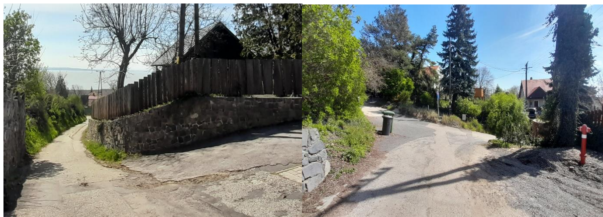
066/2 hrsz. töredezett aszfaltszél (109. ábra)
